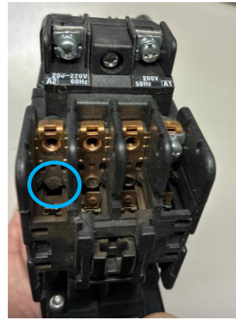
図 3 R 相の接点が消失したサーマルリレー
