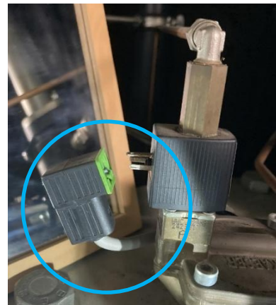
図 4-a 液化用圧縮機の制御ケーブル修理前
