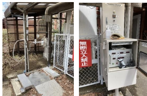
図 2 金沢大学 極低温研究室 （液体窒素供給設備）
