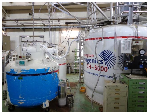
図 5. 超伝導低温工学センター （左：1,000L 容器 右：5,000L 貯槽）
