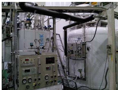
図4 ヘリウム液化機の外観
